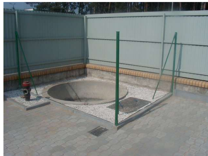
Zbiornik, separator, kratka ściekowa
