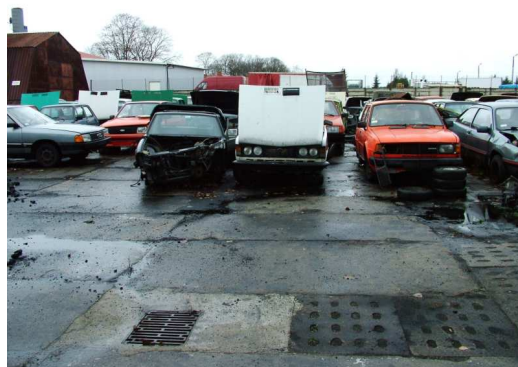
Nie w pełni utwardzona i nieszczelna powierzchnia do składowania pojazdów
